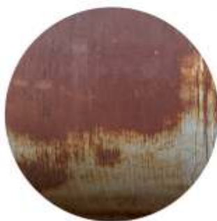
Zbiornik stalowy ulega korozji wraz z upływem czasu
